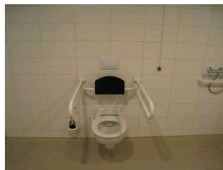
Öffentliches WC mit Dusche
